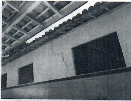
Imagem 3 – Trinca na alvenaria
