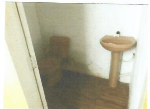
Imagem 20- Banheiro do pav. Superior (necessita de revestimento cerâmico na parede)
