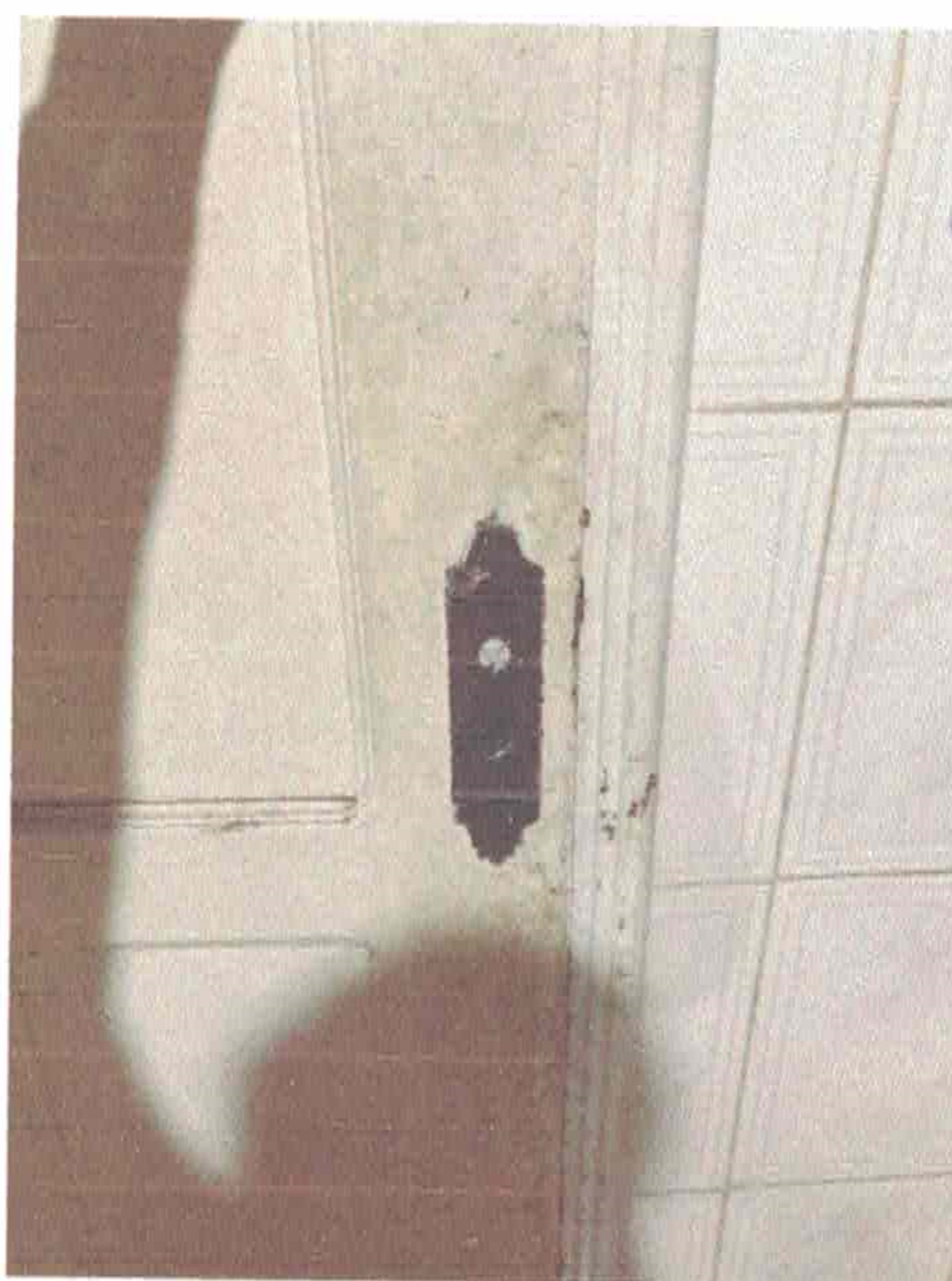
Figura 3 - Porta com fechadura danificada (Cozinha)
