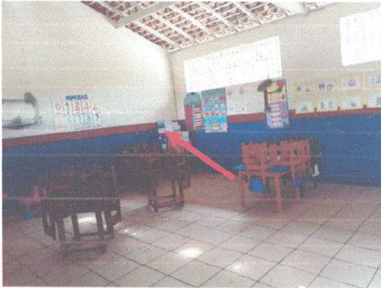
Imagem 13- Tabeiras (vistas) deterioradas
