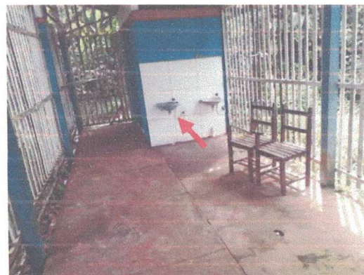
Imagem 12- lavatórios a serem trocados
