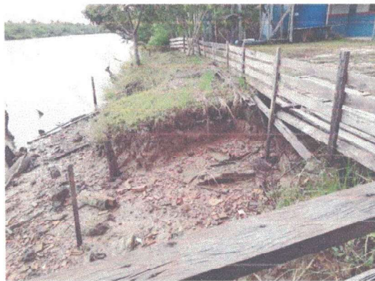
Imagem 3-Margem erodindo na parte direita
