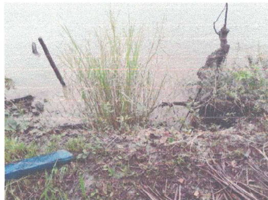
Imagem 6-Margem do rio em processo de erosão
