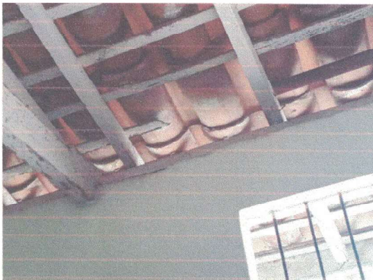
Imagem 15-Forro precisando de pequeno reparo
