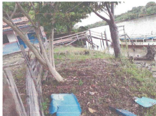
Imagem 5-Encosta em processo de erosão
