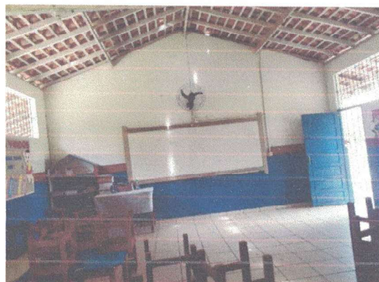
Imagem 16-Piso precisando de cerâmica
