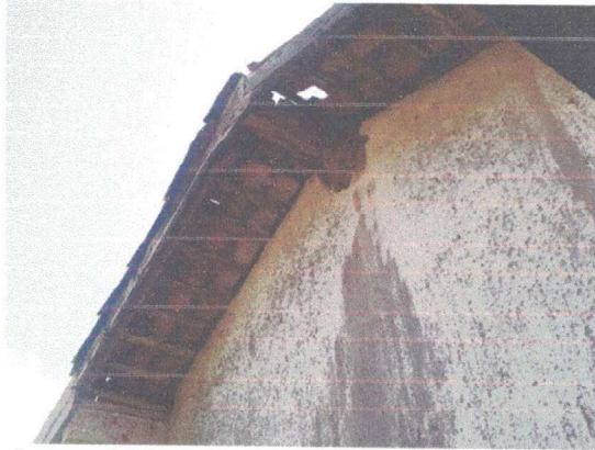
Imagem 26-Parte da estrutura de madeira da cobertura deteriorada
