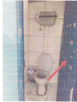
Imagem 14-Porta do banheiro a ser trocada
