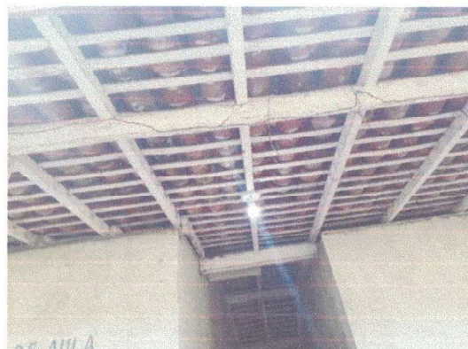
Imagem 6- Cupins na estrutura de madeira
