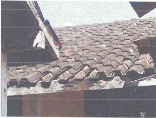
Imagem 25-Telha envelhecida, necessitando ser trocada
