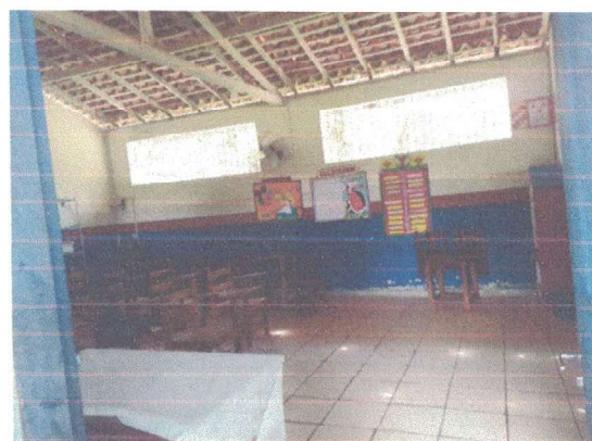
Imagem 18-Telha precisando de troca parcial e revisão
