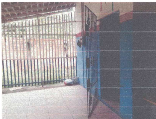
Imagem 8- Grades oxidando, precisando ser lixada e pintada
