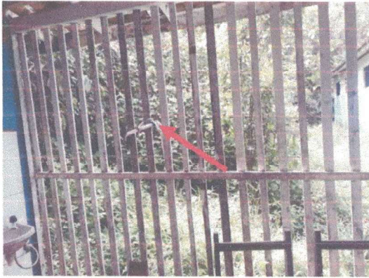
Imagem 13- Grades em madeiras a serem pintadas ou trocadas por alvenaria.
