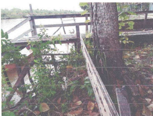
Imagem 8-Erosão na parte esquerda
