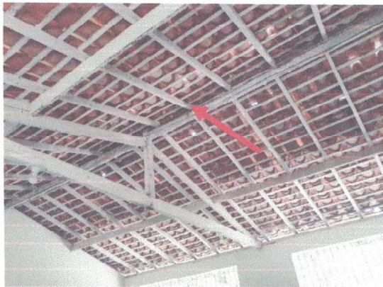
Imagem 11- Vigas com fissura no centro do vão
