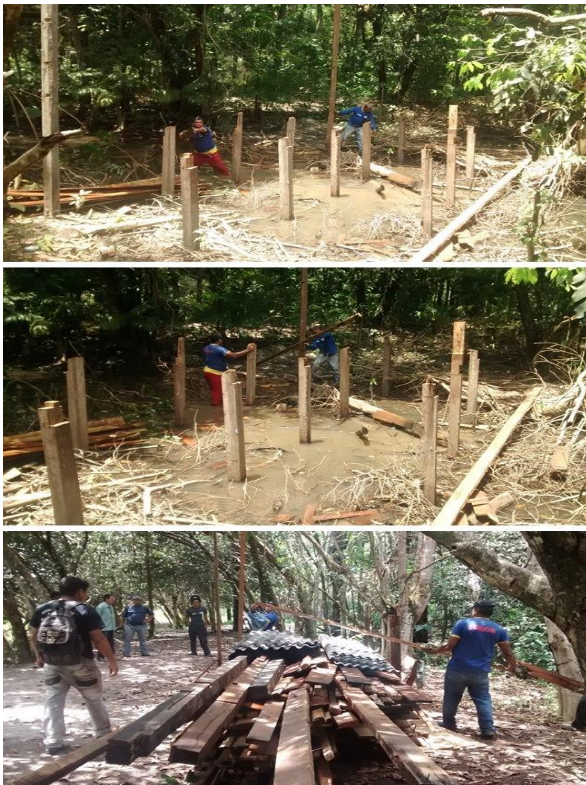
Figura 20 - Construção irregular em corpo hídrico na Vila de Beja.
